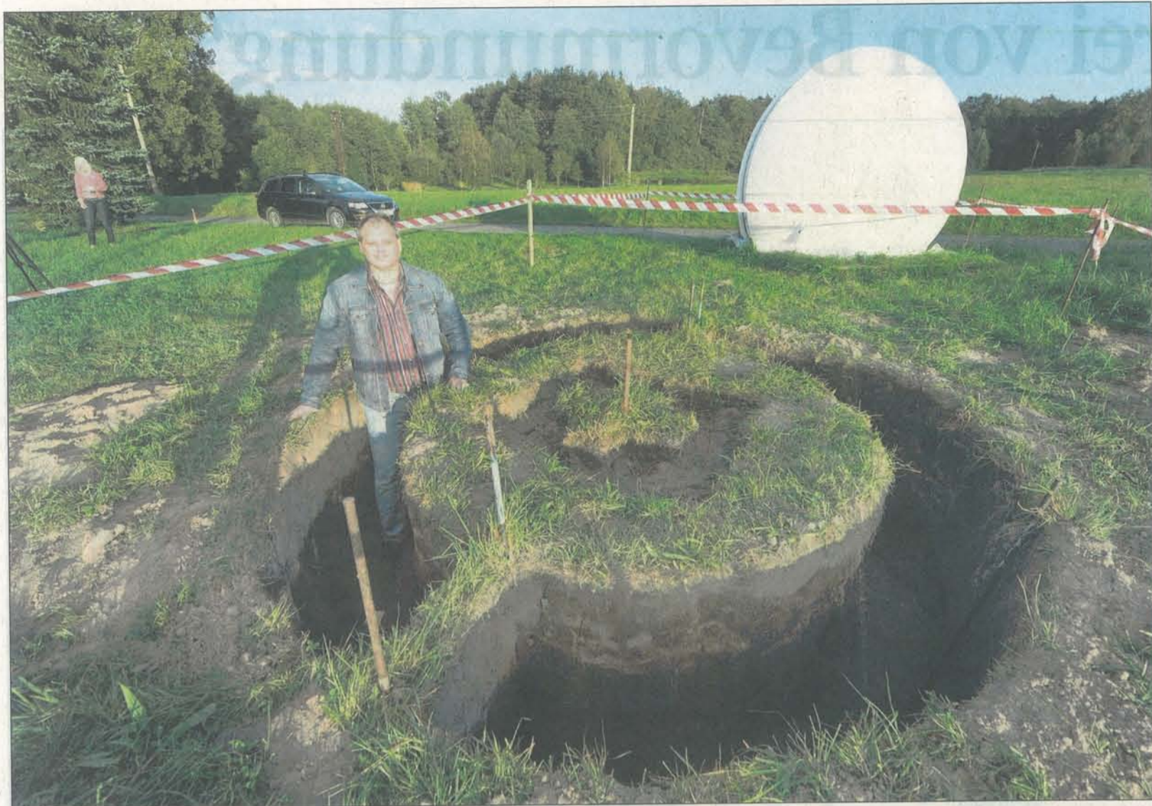
Henry Bolgehn hat mit dem Ausheben des Fundamentes schon begonnen. Hier soll bald seine Sternwarte stehen.
